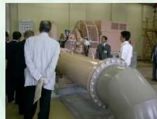
水場内 水力発電施設
