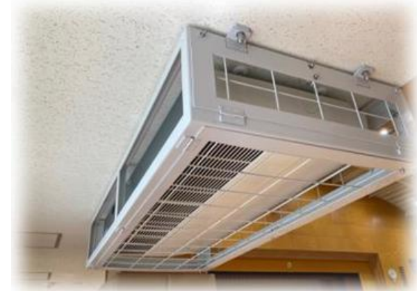
体育館空調設備イメージ
